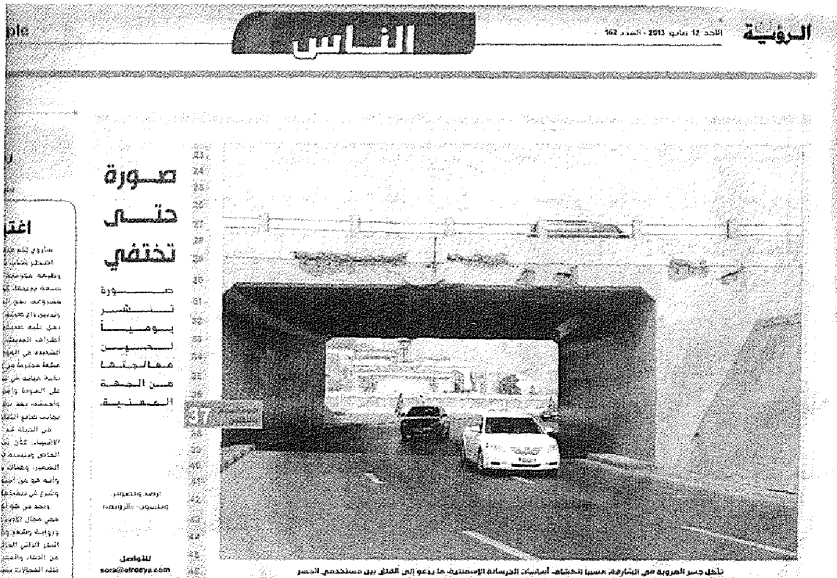
صورة « توضح تآكل جسر العروبة بالشارقة مسببًا انكشاف أساساته الخرسانية. ظلت صحيفة «الرؤية» الإماراتية تنشرها 37 يومًا في باب «صورة حتى تختفي».
